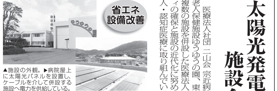
▲施設の屋根に太陽光パネルを設置し、ケーブルを介して併設する施設へ電力を供給している。
