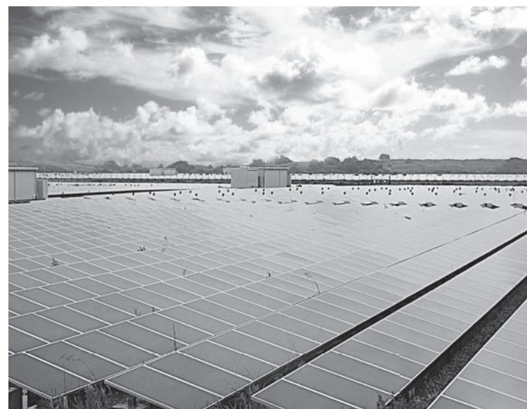
日本最大級のメガソーラー「堺太陽光発電所」。
