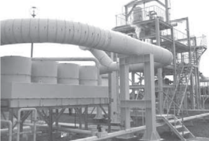
東京電力八丈島地熱発電所。排出する蒸気は硫化水素除去装置を通し、環境に影響を与えないクリーンな状態にしている。
